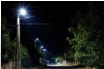
Устройство уличного освещения на территории округа
